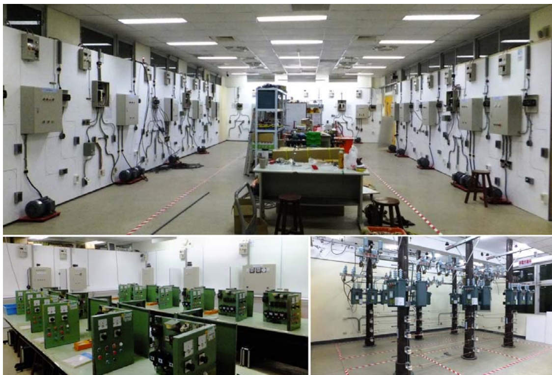
室內配線乙丙級檢定場
